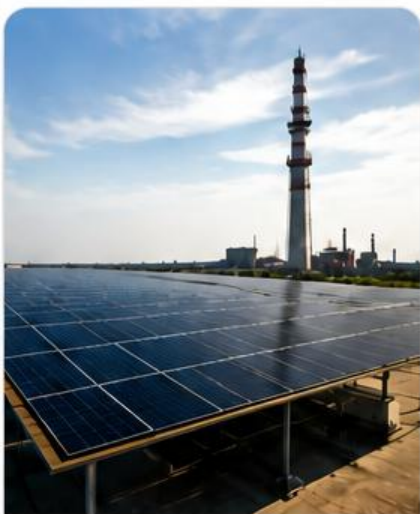
Ittehad Steel 4 MW
